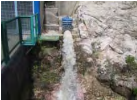
[写真-21] 既存の転流管路の出口 渇水時期にはこうしてバルブを開放し、ダムの貯水量を補うこととしている。
