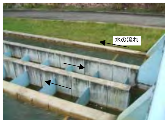
[写真-28] フロック形成池 フロック形成池は1系統当たり3つの水路を有する。迂流板の配置に問題があり、流入水量が管理されていないため、最初の水路で短絡流(オーバーフロー)が見られる。 迂流板の間を上下に適切に通過するように板間隔を調整する必要がある。
