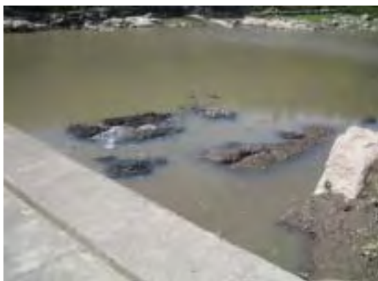
[写真-23] オホホナ川の取水堰 上流からの土砂が多く堆積するため、取水機能は大きく低下している可能性がある。 定期的な土砂排出が必要であるが、取水地点のバルブや管路には問題は見られない。
