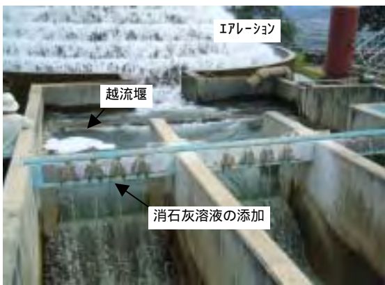
[写真-27] ピカチヨ浄水場の流入部 4系統の流入水はエアレーション施設及び合流槽を経て3つの処理系統に分配される。 この合流槽には越流水深を測るセンサーがあるが、流入水量833ℓ/秒が測定範囲の上限である。雨期にはこれを大幅に上回る水量(1000ℓ/秒以上)が流入するため、処理能力の拡張と併せて水量測定設備の更新が必要である。
