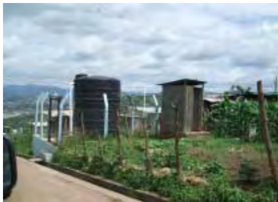
[写真-16] SANAAが整備した簡易配水タンク SANAAが給水対象としている貧困地区にはこうしたタンクが整備されている。タンクはSANAAや住民組織が管理している。SANAA直轄給水車(UEBD)により定期的に水を供給し、住民組織から運搬費用を徴収することで、地域の給水事情の改善を図っている。
