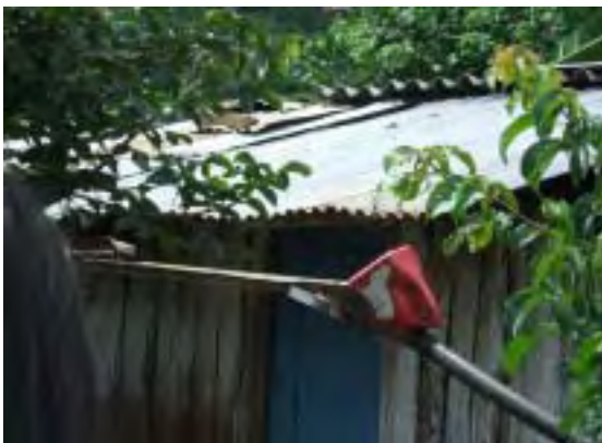
[写真-17] 雨水の貯留施設 各家庭はこうした簡素な施設を用いて、雨水を貯水している。 市南東部の貧困地区では配管網は存在するものの、コンセプション系統からの送水ポンプによる供給量が限られており、20日程度に1回(2～3時間)の給水状況となっている。
