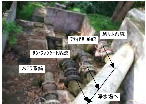
[写真-26] ピカチヨ浄水場の流入管 導水管路は4系統あるが、系統別の流入水量が測定できる設備がない。 このため、全体の流入水量が低下した際、問題のある系統を即座に特定することが難しい。
