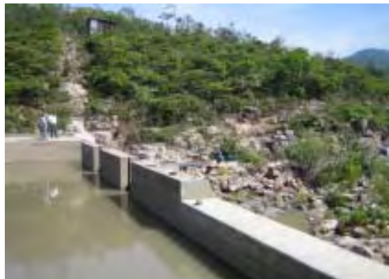
[写真-24] オホホナ川の取水堰 雨期に入る直前(5月時点)の状況。 流域の雨量データや河川流量の分析がなされておらず、年間の可能取水量が不明である。
