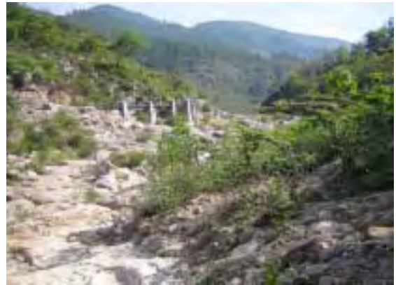
[写真-22] オホホナ川取水堰からの転流管路 ダクタイト管(400mm)が敷設されているが、コンセプションダムまでの途中で管径が小さくなっている箇所があり、通水阻害をもたらしている可能性がある。
