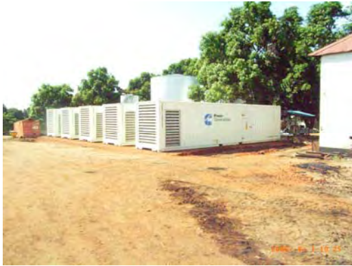
新設発電機 (1MWx5)
