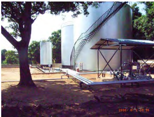
新設燃料設備
