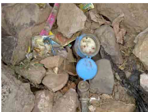
写真-39 各戸給水の水道メーター 村落部においてもパイプ給水は全て各戸給水で、各戸の 屋外の路上に水道メーターを設置する規則となっている。 写真のメーターはイタリア製。
