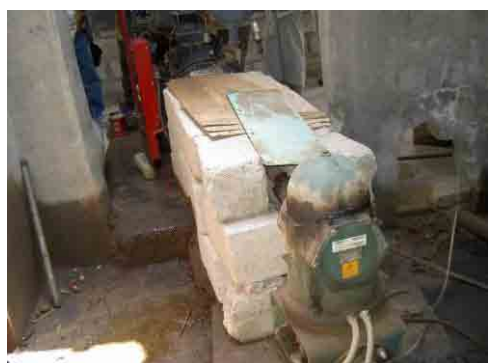
写真-40 普及しているエンジン直動のパーティカルポンプ ダマール州 Waraqah 村。1982 年に日本の無償により水中 ポンプと発電機が設置された。老朽化のため住民がエ ンジン直動のパーティカルポンプを 400 万リアルで購入し交換。
