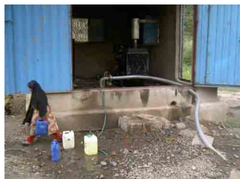
写真-8 Shab Humran 村の深井戸 水中ポンプとディーゼル発電機 (105kVA)。1 日 18 時間運転で 300m 3 を揚水している。2 本の深井戸で約 3,000 人 (19 村) に給水している。既存システムの拡張を要望。
