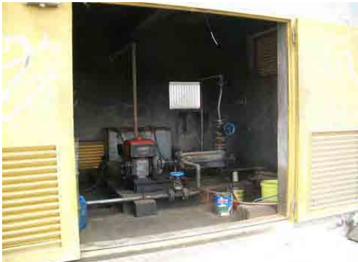
第2中継施設ポンプ、エンジン
