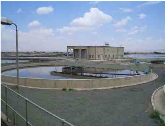
最終沈殿池（3次処理）
