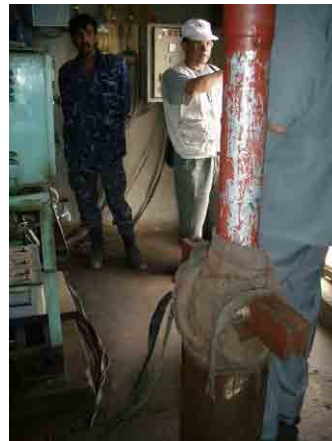
当初の発電機が故障し、配電盤に切り替え
