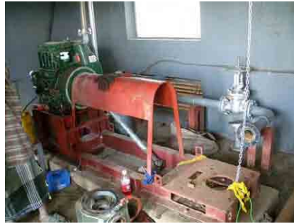
発電機、エンジン、ポンプは外されている。
