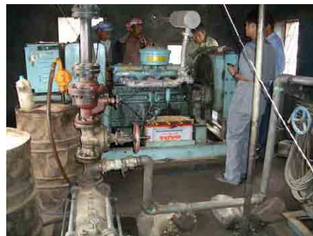
供与のポンプ、エンジン、オイル漏れあり 日本製部品が入手できないため代用品を加工して使用
