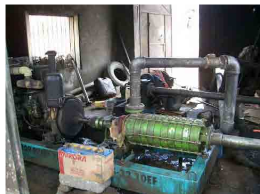
中継ポンプ、数回取替えられている
