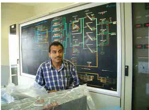
下水処理場中央制御パネル
