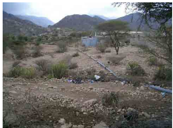
GARWSP により敷設された山地集落への送水パイプ 水源が枯れ、送水されていない
