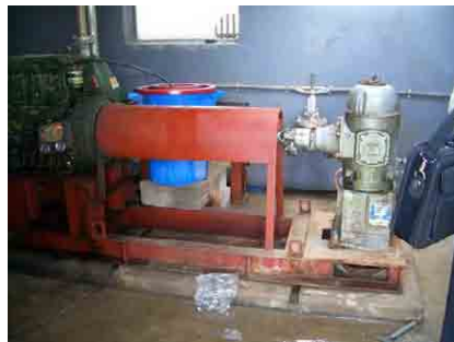
発電機、エンジン、ポンプ
