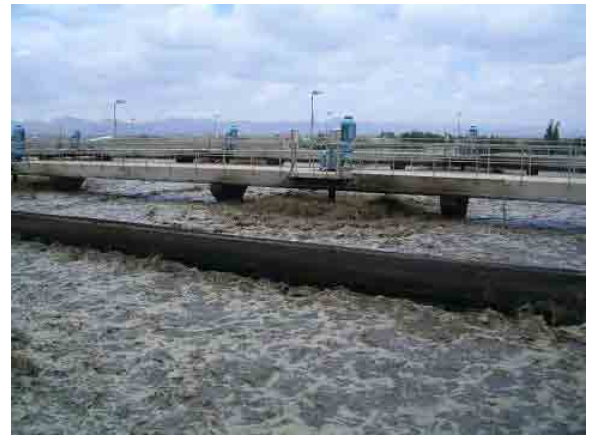
エアレーションタンク（2次処理）
