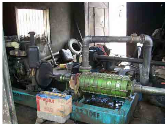
中継ポンプ、数回取替えられている
