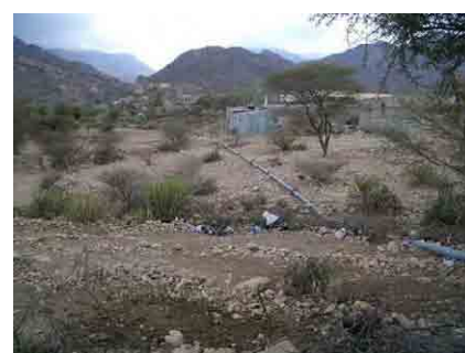
GARWSP が敷設した山地集落への送水パイプ。水源が枯渇、送水されていない。
