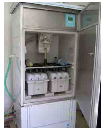
38. 水質自動サンプリング容器(Bou Salem 町の橋梁地点)
