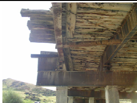
写真 桁の変形状況
