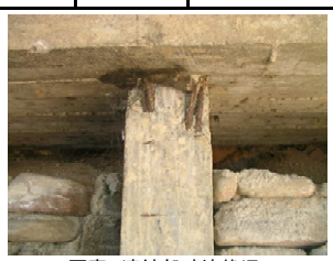
写真 連結部破壊状況
