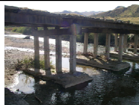
写真 橋脚の洗掘状況
