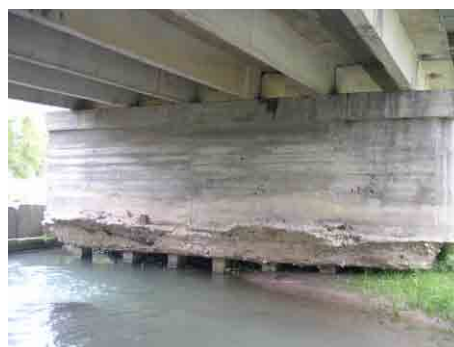
フーチングが剥ぎ取られた橋脚
