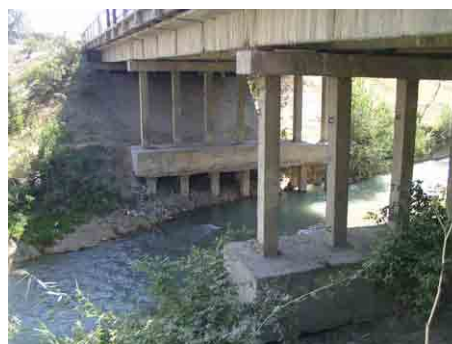
洗掘された橋脚フーチング
