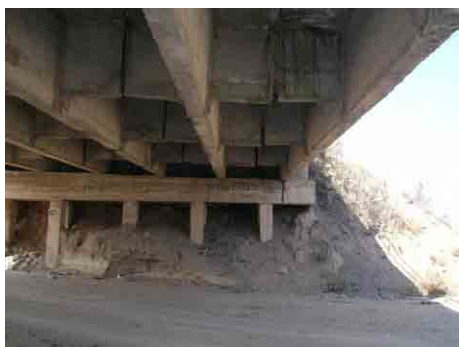
No.23 橋梁 主桁に回転が見られる
