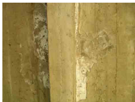
主桁部 コンクリートの剥離
