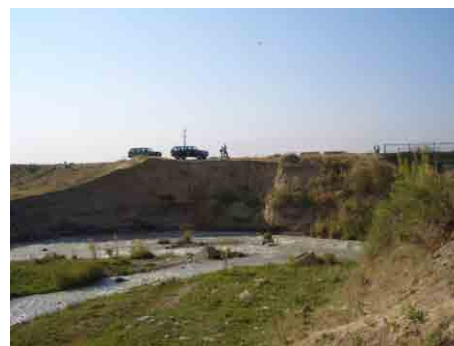
洪水によって大きく削りとられた護岸 （下流、右岸側）
