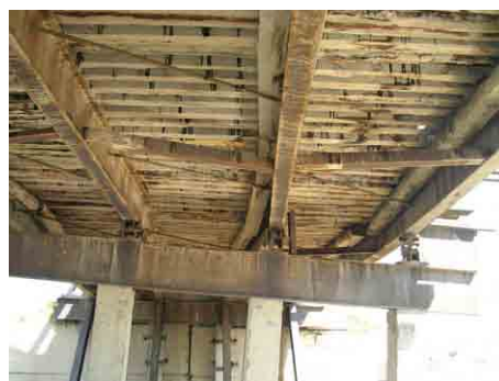
傾いている受け梁
