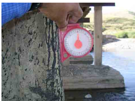
傾いている下部工
