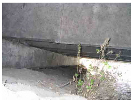
No.15(1)橋台部の状況
