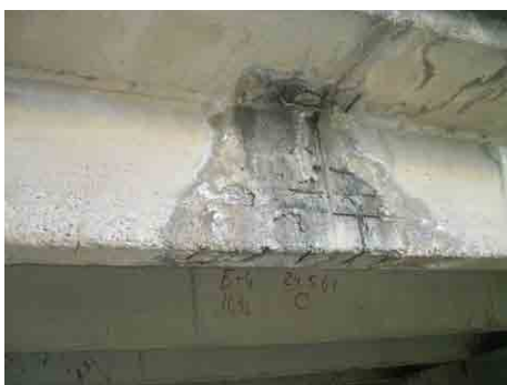
主桁部の損傷
