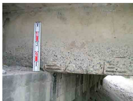
No.19 橋台部に見られるひび割れ
