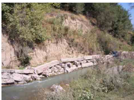
崩壊した護岸（下流、左岸側）
