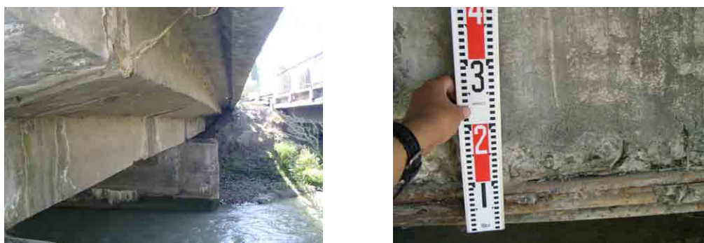
No.14(1) 橋梁主桁の損傷
