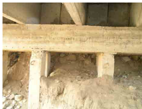
No.23 支承がない
