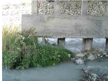
洗掘された橋脚部
