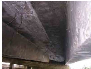
主桁の損傷部分
