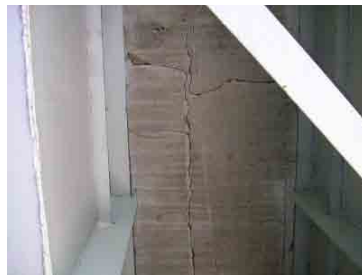
床版部に入ったクラック
