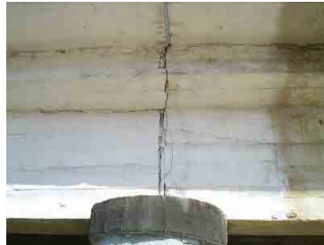
橋脚部付近の主桁損傷
