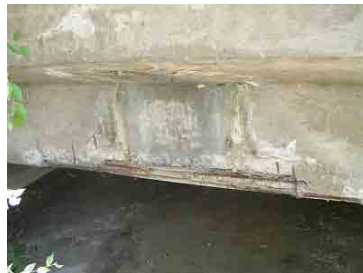
主桁の損傷部分
