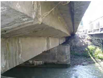
補修痕の見られる主桁
