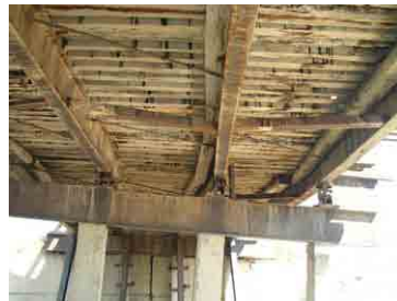
上部工の横方向の変形
