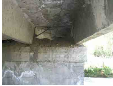
橋脚部の損傷
