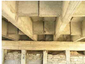
主桁の回転とパイル頭部の破損
