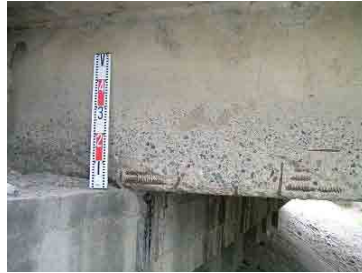
桁端部鉄筋露出、せん断クラック
