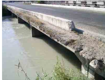
張り出し床版の破損
