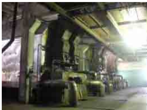
< RDF түлшийг нүүрстэй хольж шатаах туршилт> RDF түлшийг нүүрстэй 2% ба 4%-р тус тус хольж шатаах туршилтыг Налайхын дулааны станц дээр хийсэн.
