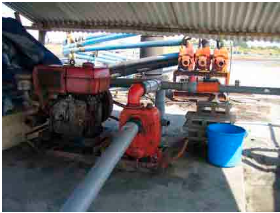
A-7 海水取水ポンプ施設
