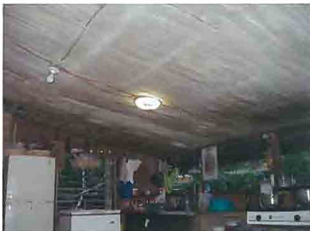
PVで点灯している蛍光灯
