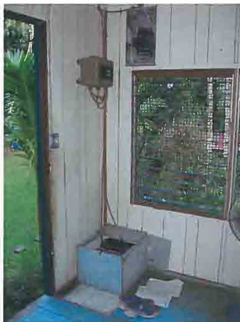
チャージコントローラーとバッテリー
