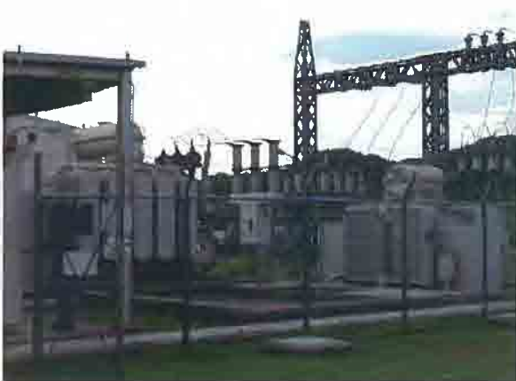
Malakal 開閉所全景
