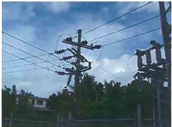
Malakal 開閉所の送電線出口
