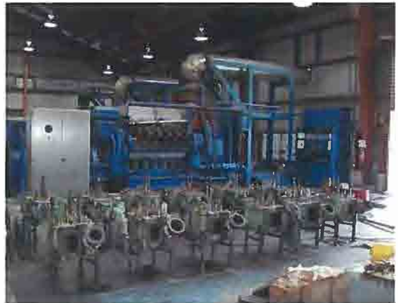
修理中のワルチラ社ディーゼル発電機
