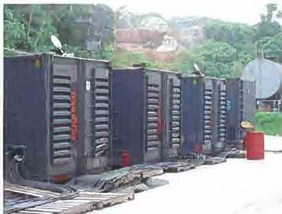
リース中のディーゼル発電機
