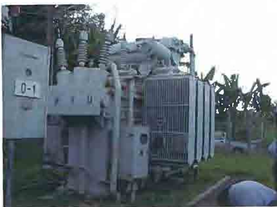
写真3-7 Airai変電所の変圧器 (34.5/13.8kV, 10MVA)
