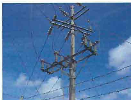
写真3-2 Kokusai変電所からイボパンへの34.5kV、1回線送電線
