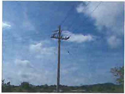
写真3-4 コクサイーイボハンアサヒの34.5kV、1回線送電線
