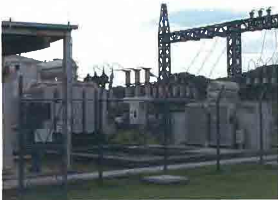
写真3-5 Malakal発電所の変圧器 (10MVA, 3.5MVA, 1.75MVA)
