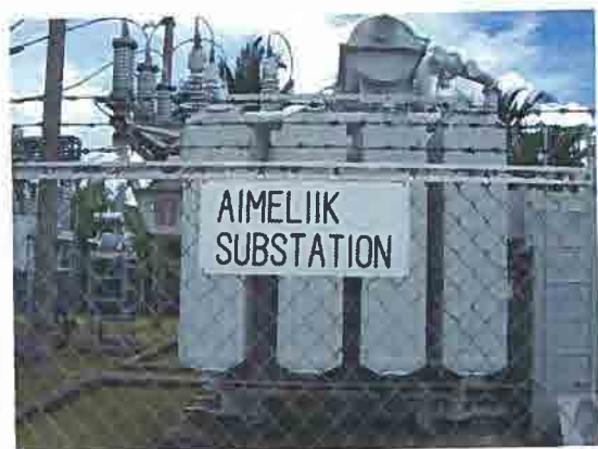
写真3-8 Aimeliik発電所の変圧器 (13.8/34.5kV, 10MVA)
