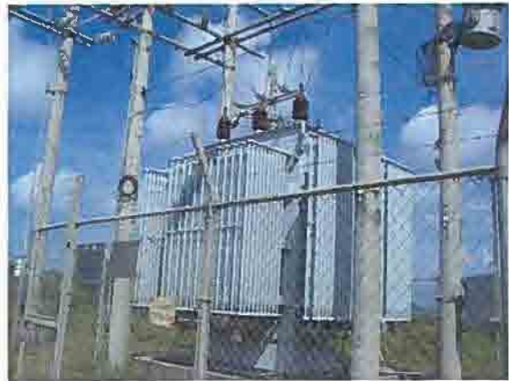
写真3-6 Kokusai変電所の変圧器 (34.5/13.8kV, 5MVA)
