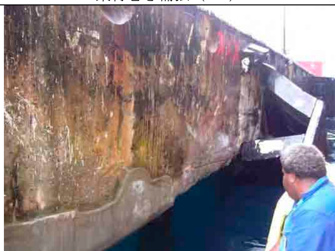
防舷材破損状況
