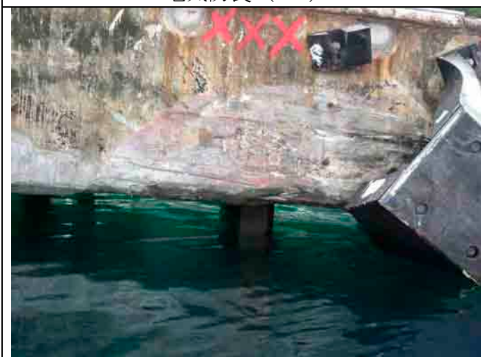
貨物船の岸壁接触、上下左右方向応力によりボルト破断 (1月11日貨物船着岸時)
