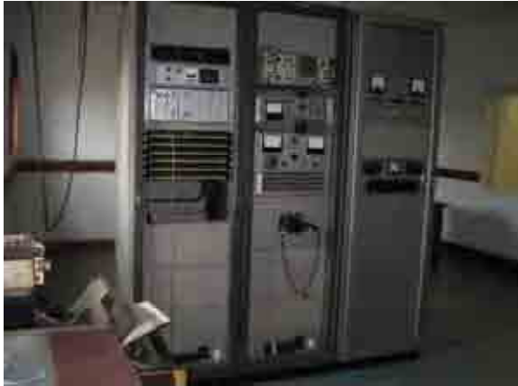
ケリバ中波送信所 / コントロール室の 番組入力監視装置
