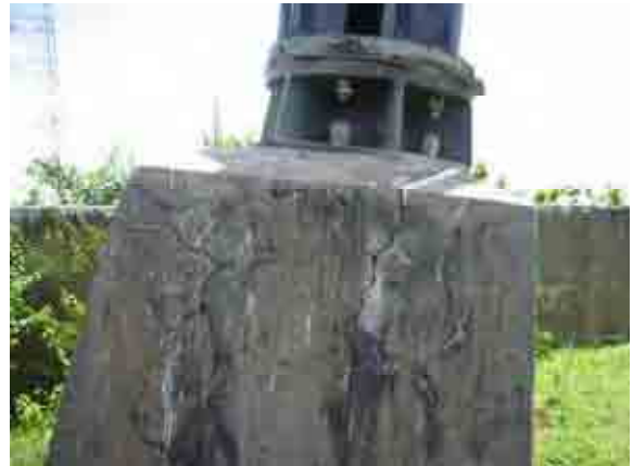
マワガ中波送信所 / 送信アンテナ基礎部分 基礎コンクリートに構造的なクラックが見受けられる。
