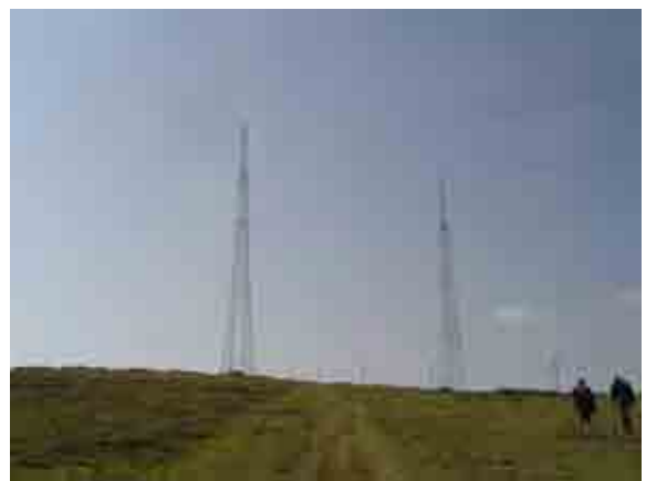
ケリバ中波送信所 / 送信アンテナ鉄塔 マワガ送信所同様 1972年に建設された主副の2本の75m自立式鉄塔。左側が主アンテナ、右側が副アンテナ。隣国への影響を抑えるため、指向性を持たせている。
