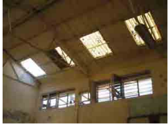
マワガ中波送信所 / 既設送信局舎天井部分 屋根や窓など損傷が激しく、雨漏りは避けられない状態となっている。
