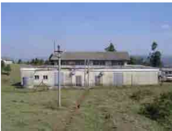
ケリバ中波送信所 / 既存送信局舎外観 建屋低層部はコンクリートスラブの陸屋根であったが、漏水が激しいため、スラブ上に更に小屋組を設けてタン屋根葺きとしている。
