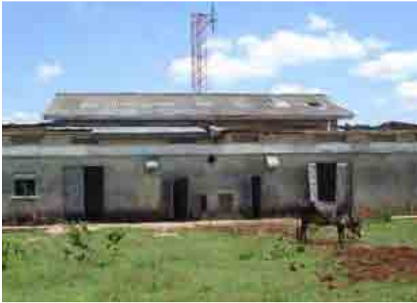
マワガ中波送信所 / 既存送信局舎外観 外壁、屋根、扉、窓など建物全体の老朽化が著しい。
