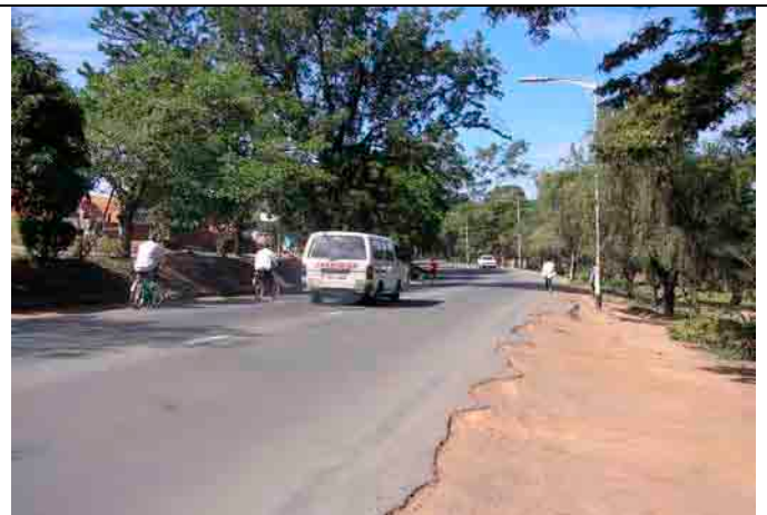
自然条件と道路状況 (Chipembere Highway) 強い降雨により道路舗装の端部が洗掘されている。
