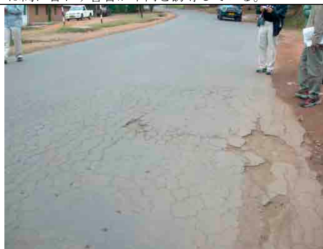
重量車の走行、アスファルト厚の不足により舗装面の損傷が著しい。
