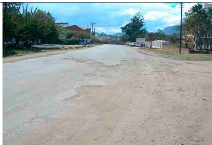
ブランタイヤの Ginnery Corner 工業地帯の道路。舗装面が著しく損傷している。
