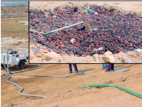
Fotografía 2-8 Sistema de tratamiento de recirculación de lixiviados en un relleno de la ciudad de México
