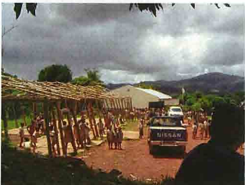
建設が中断している父母会による教室棟
