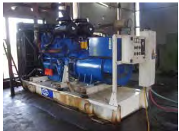
非常用発電機
