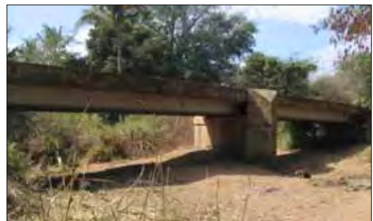
写真-6: 既設橋の現況( 床版の鉄筋露出、橋脚・橋台にクラックが発生、詳細は本文参照)
