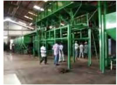
工場内の加工設備
