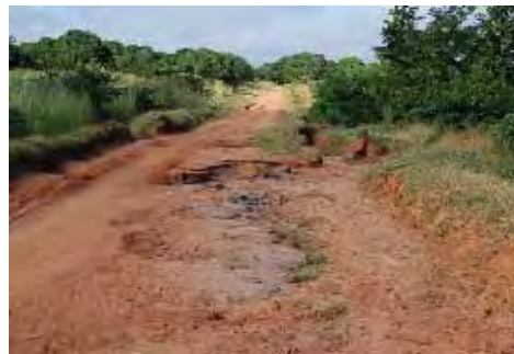
降雨による既存土道の浸食
