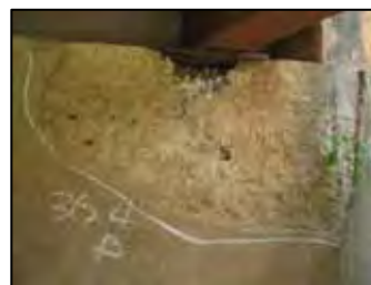
橋台・橋脚のダメージ
