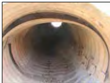
既存コルゲートパイプの損傷状況-1
