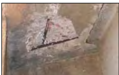
橋梁コンクリート床版のダメージ
