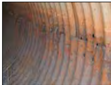
既存コルゲートパイプの損傷状況-2
