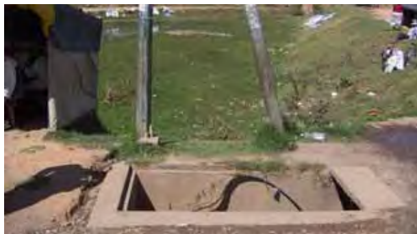
終点部交差点の地下電信ケーブル
