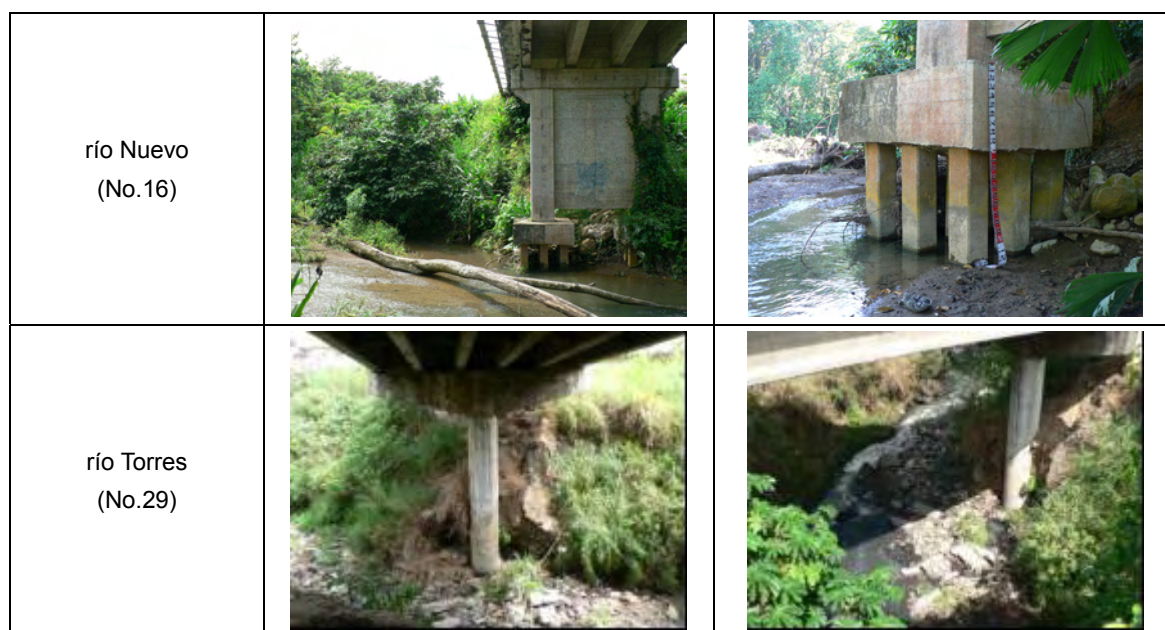
Figura 11.7.4. Socavación del lecho del Río alrededor de la pila
