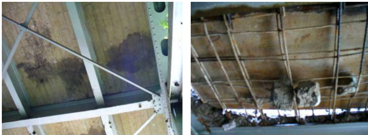
Figura 11.1.2. Daños en la losa del Puente de cercha
