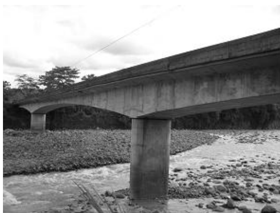
Figura 10.3.3. Deposito de Grande Rocas en el Puente río Chirripó No.17
