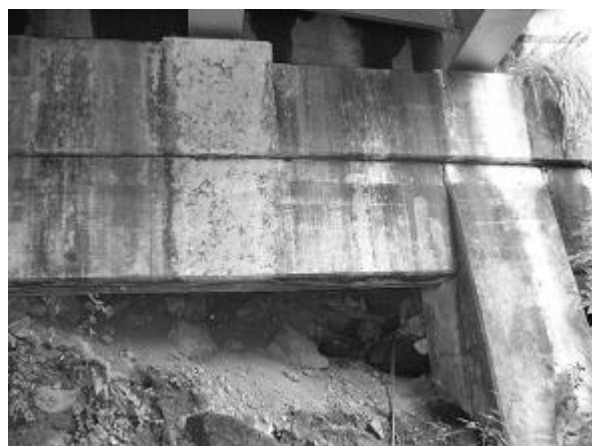
Figura 10.3.2. Erosión en los Rellenos del puente sobre río Puerto Nuevo No.12
