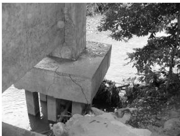
Figura 10.3.1 Socavación en el Cauce del puente sobre río Nuevo No.16
