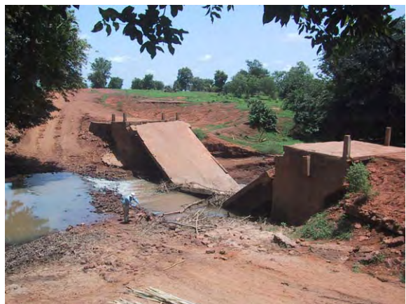
落橋した既存バレ橋（L=21.5m）
