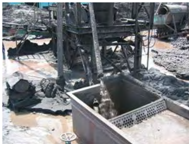
写真 5-2-1 溢流水バイパスパイプ
