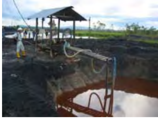
写真 4-2-4 中和処理設備
