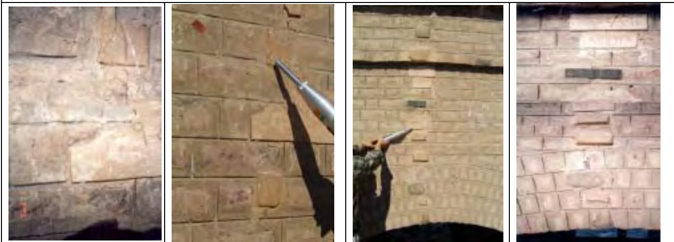
上流側胸壁部アーチクラウン部クラック及び検出盤（両端の写真・出典 RGSB:1996/2/2）
