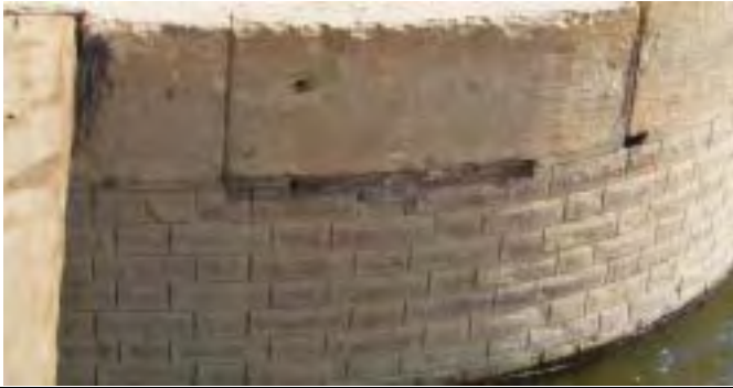
堰柱先端(笠石下部のレンガ一部欠損)
