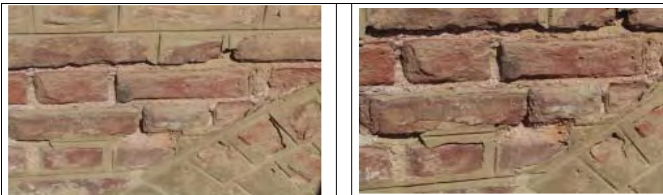
レンガ表面及び目地の劣化
