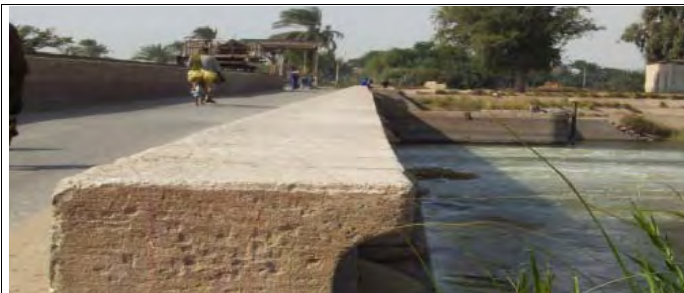
管理橋車止めが下流側に湾曲
