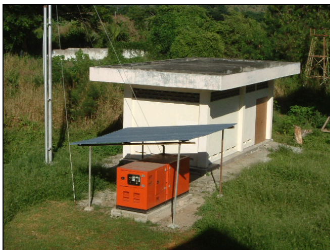
不安定な配電に対応するため、キャンパス内にジェネレーター（発電機）を設定している。
