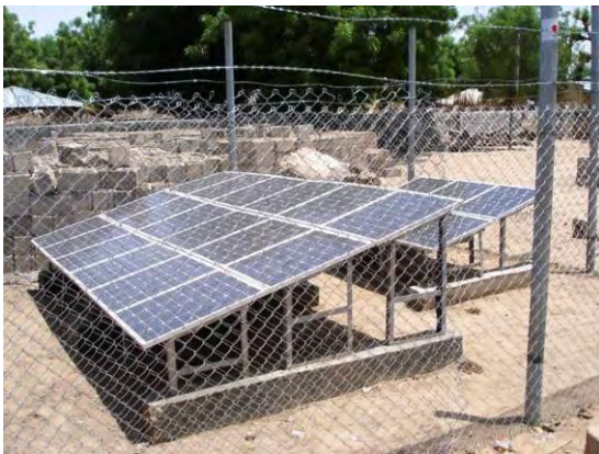
3) PV アレイ外観。写真手前が BCS 用で公称最大出力 1,080W (60W×18 枚)、写真奥が公共施設用で公称最大出力 360W (60W×6 枚)。PV アレイは傾斜角 15 度、方位南向き。
