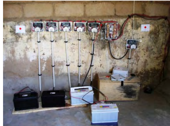
2) BCS ステーション内部。充電回路は 5 回路 (各 20A)。バッテリーは液式で容量 88Ah。
