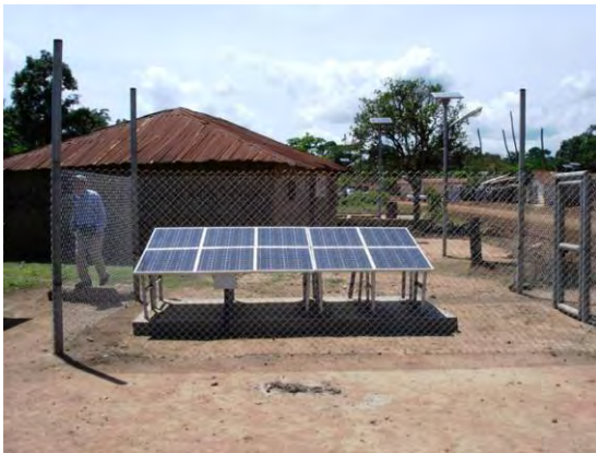
3) 公共施設用 PV アレイ外観。PV モジュールはジガワ州と同様で 60W。PV モジュール計 10 枚のうち、6 枚を照明用、4 枚を PV ワクチン冷蔵庫用に使用している。
