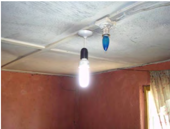
3) SHS 用蛍光灯(11W)の点灯状況。期待寿命は 5,000 時間以上。
