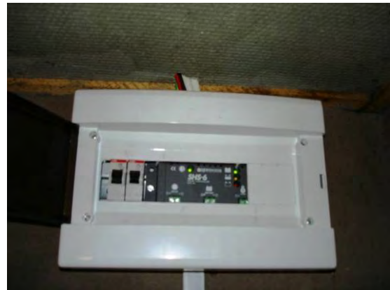
4) SHS 用ジャンクションボックス外観。ボックス内にはチャージコントローラー(6A)と配線用遮断器を収納。チャージコントローラーにはバッテリーの充電状態を知らせるランプがついている。
