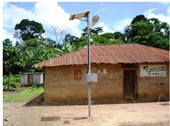
6) 街路灯外観。機材仕様は全てジガワ州街路灯と同様。日射量を考慮して照明点灯時間は 4 時間/日（日没後 3 時間、日出前 1 時間）とした。
