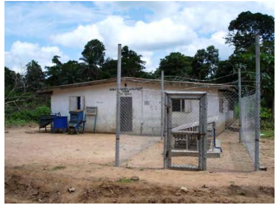
2) 公共施設（クリニック）外観。蛍光灯 15W×10灯とPV ワクチン冷蔵庫 1台を設置。
