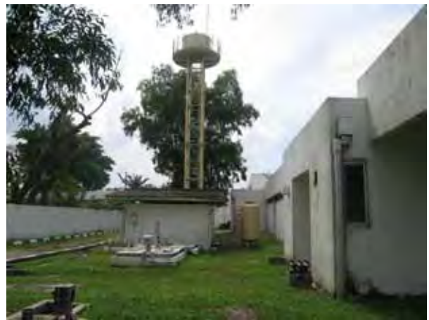
写真 4: 給水施設 滅菌処理装置、給水クリーナー、及び軟化装置が耐用年数を超えており、更新が必要である。
