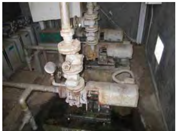
写真 6: 稼働中の揚水ポンプ
