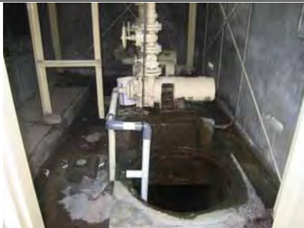
写真 5: 揚水ポンプ 高架水槽へ給水する揚水ポンプはすでに耐用年数を超えており更新が必要である。
