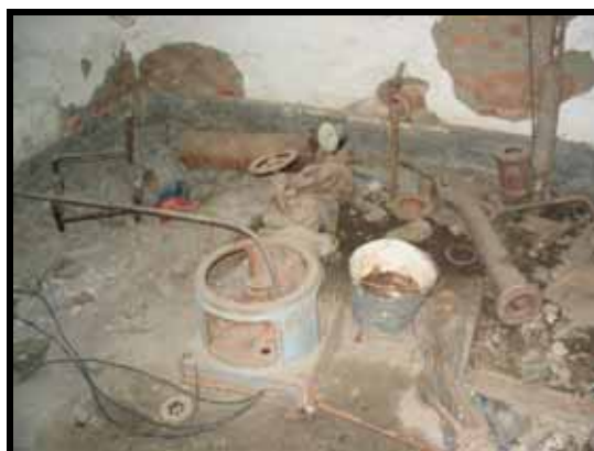
メヌントゥガイ村既存給水施設の機械室。水中ポンプ、制御盤、配管などの修復が必要である。写真にはないが、変電設備も損傷を受け機能停止している。
