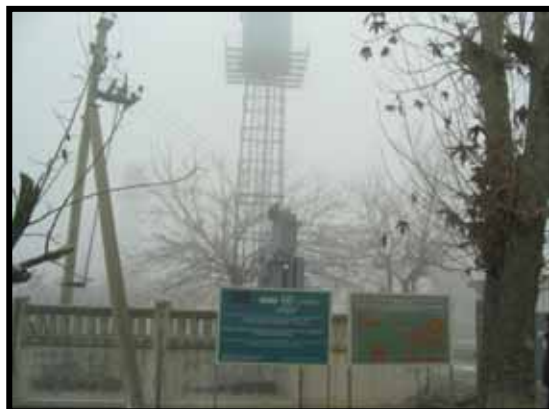
農村平野部のチャパエフ村（チュベック）。2002年 UNDP 支援より改修された小規模村落給水施設。2006年にポンプ故障が発生し休止している。
