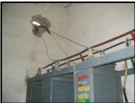
モスコフスキー上下水道公社の変電設備。旧ソビエト時代から使われているソビエト製の旧式な設備。
