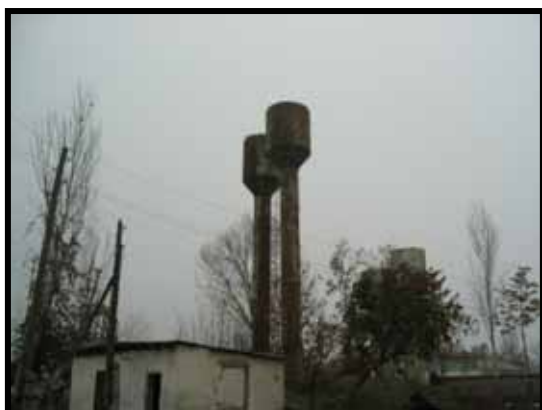
メヌントゥガイ村（トゥルディエフ）既存給水施設の高架タンク。3基の高架タンクの改修が必要である。
