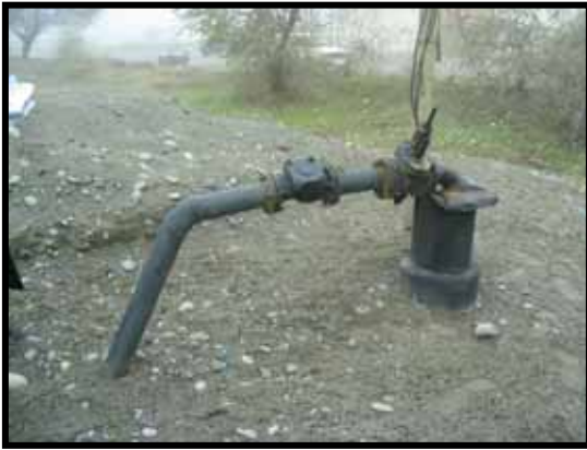
ピアンジ河右岸のパンジヨブ村の既存給水施設。洪水で全壊し、大統領命令で緊急的に深井戸が新設された。ただし、塩素滅菌装置は設置されていない。
