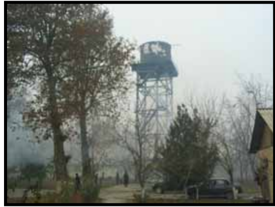
モスコフスキー上下水道公社敷地内の老朽化した高架タンク（容量は100m 3 ）。現在の給水量からみて、大容量のタンク新設の必要性がある。
