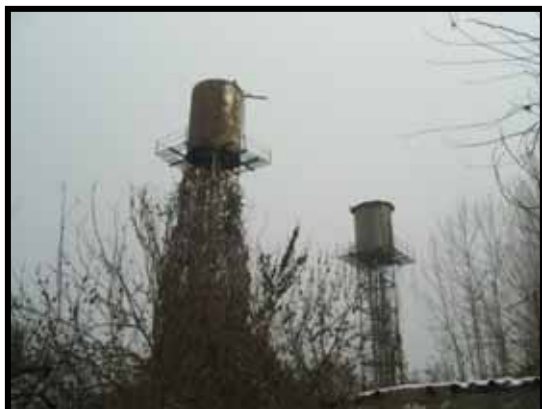
ファイザバッド2村（ダシティグロ）の高架タンク2基。老朽化が激しく、1基（容量50m 3 ）は改修が必要である。
