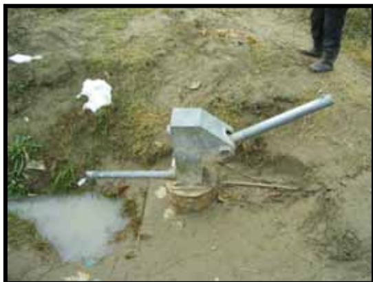
平野部ファイザバッド1村（ダシティグロ）。2005年洪水で取水施設が全て壊滅した。浅深井戸にハンドポンプを緊急設置しているが、水質は極度に悪い。
