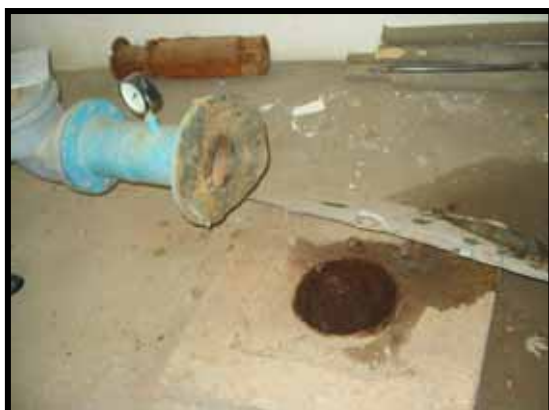
チャパエフ村給水施設の深井戸の現況。水中ポンプが故障し取り外されている。
