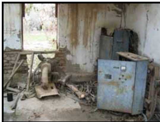
洪水によって壊滅したファイザバッド1村給水施設の機械室内部。水中ポンプ、制御盤や配管が被害を受けている。
