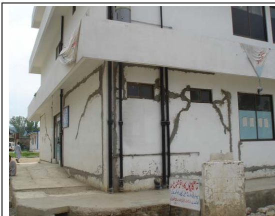
地震のダメージを受けた鉄筋コンクリート 建造物
