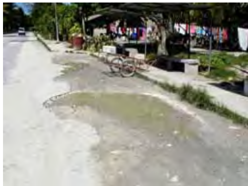
写真 3: バス停前の舗装が剥がれて水溜まりとなっているため、ミニバスはここに停車できない。
