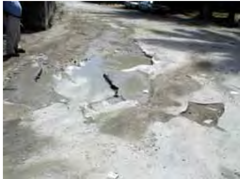
写真 5: トゥンガル中央病院の前ではポットホールが拡大し、路面の欠損へと発展している。
