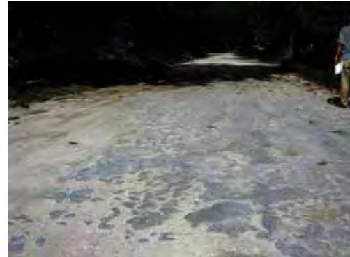
写真 6: バイリキワーフ道路では亀甲クラックが発生し、舗装が既に剥がれているところが多い。
