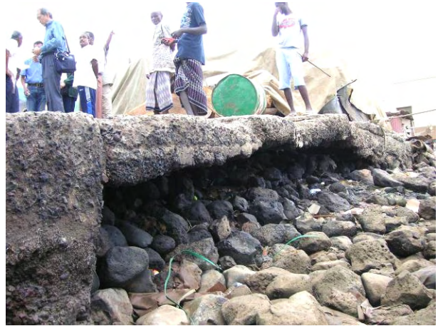
スリップウェイの地盤崩壊状況
