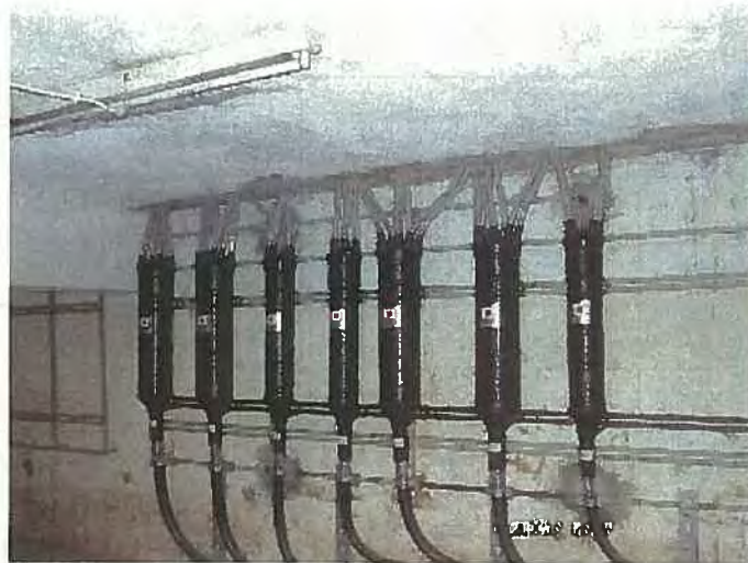
サン・パウロ局 地下ケーブル室
