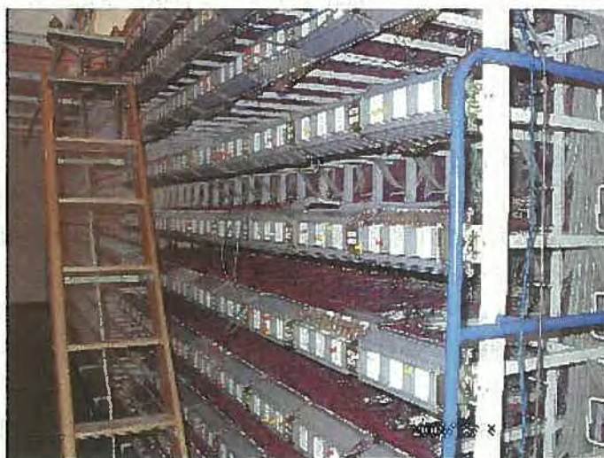
アルメダ局 局内設備 (MDF：主配線盤)
