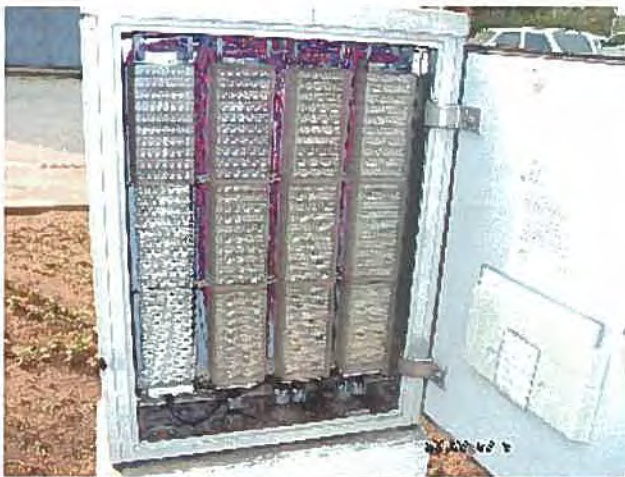
過去に日本の協力により整備されたルアンダ市アルバラーデ局の屋外切替接続盤
