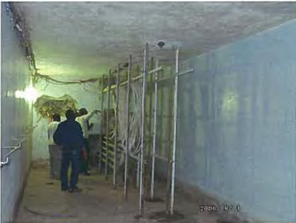
ベンゲラ電話局内マンホール室
