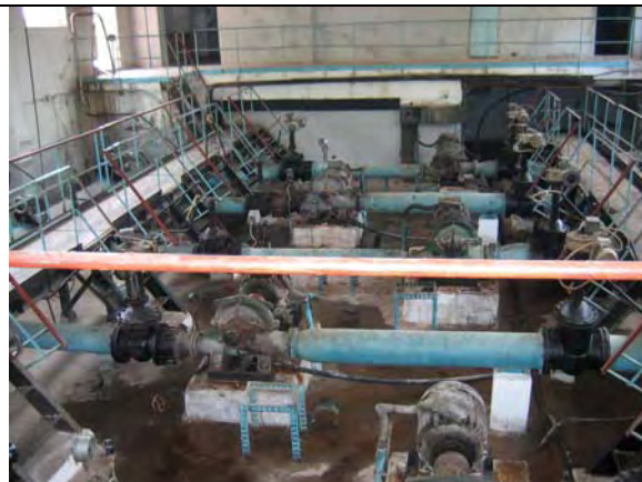
④配水ポンプ場
