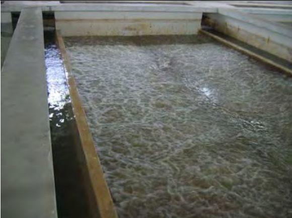
⑤ろ過池逆洗中
