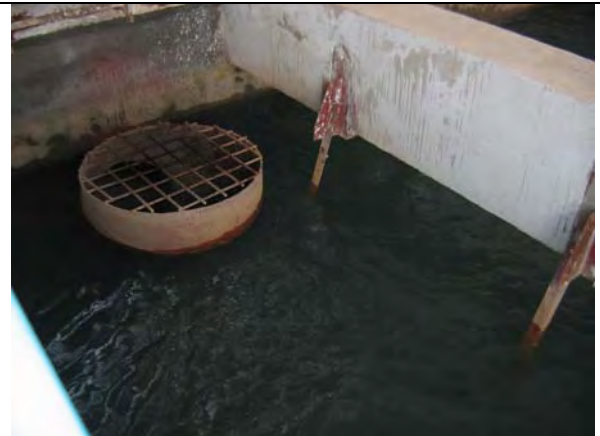
④急速ろ過池
