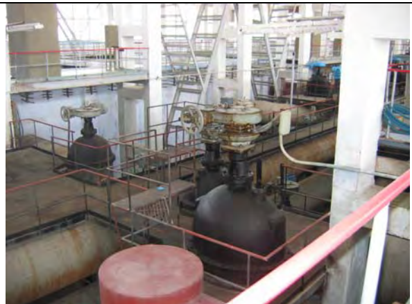
⑤配水ポンプ
