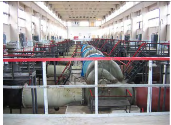
⑥配水ポンプ
