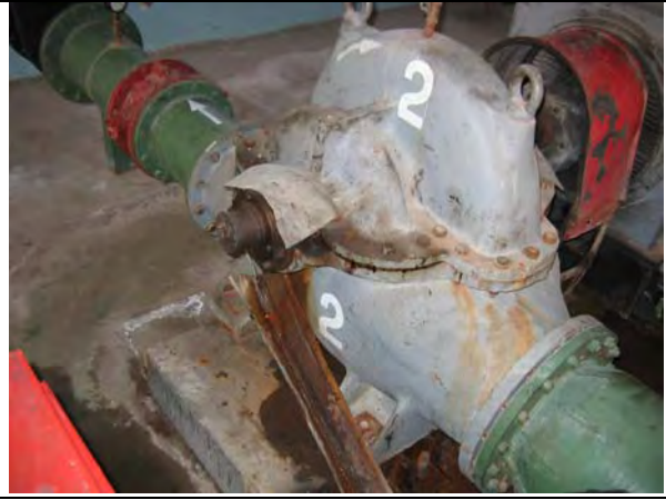
⑥配水ポンプ
