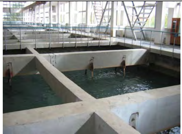
③急速ろ過池
