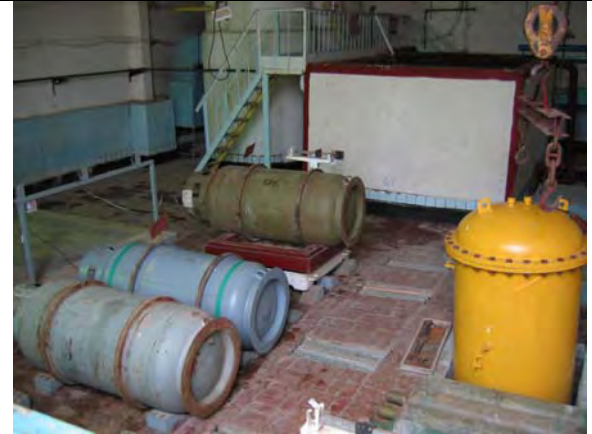
④塩素注入室
