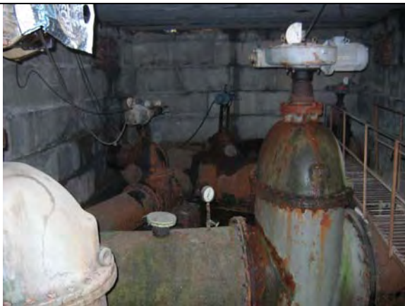
③浄水池連絡弁室内
