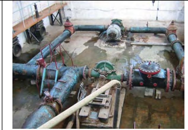
④配水ポンプ
