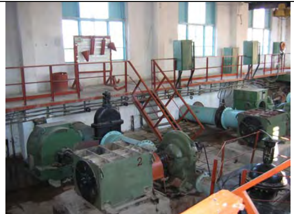
③配水ポンプ
