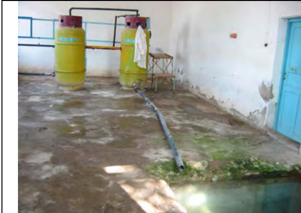
③塩素注入点
