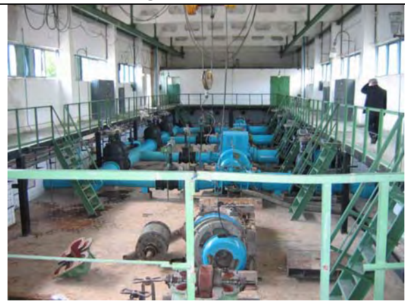
⑥配水ポンプ
