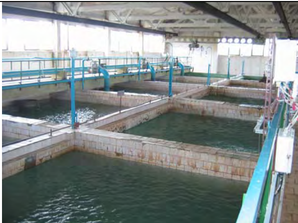
③急速ろ過池
