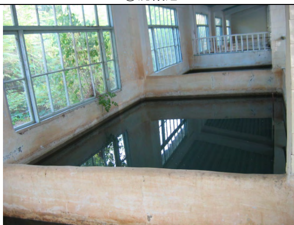
④急速ろ過池
