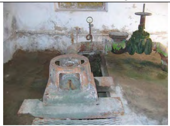
①地下水揚水ポンプ
