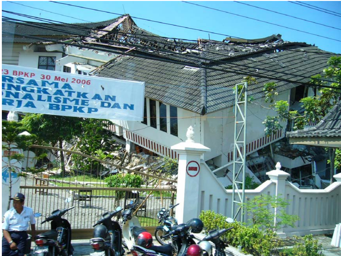
ジョグジャカルタ市の倒壊家屋
