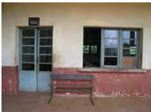
隣接中学校の廊下（損傷したままの教室のドアや窓）
