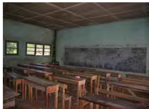
中学校の教室内部（老朽化している天井や壁）
