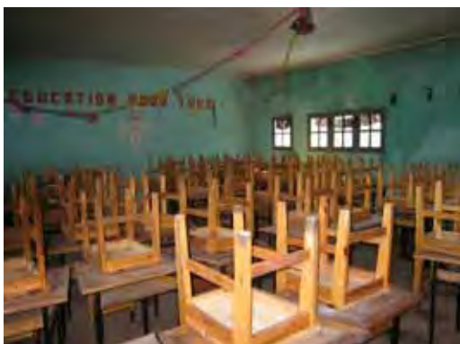
教室内部（雨漏りによる壁の汚れが目立つ）
