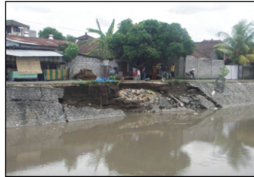
Kerusakan Tanggul didekat hulu JL. P. Misol (Dari sisi tanggul sebelah kiri)
