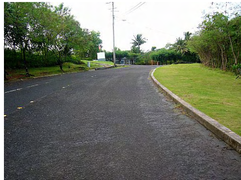
Section F-3 STA. 12+960 Ravelling
