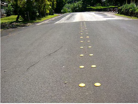
Section C STA. 6+030 Ravelling
