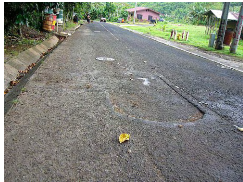
Section E-2 STA. 3+300 Ravelling
