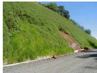
【斜面崩壊箇所】
