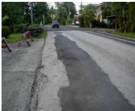
写真7 膨れ上がった舗装損傷箇所
