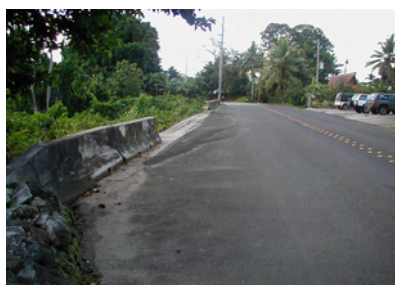
写真9 地すべりによって防護柵が転落
