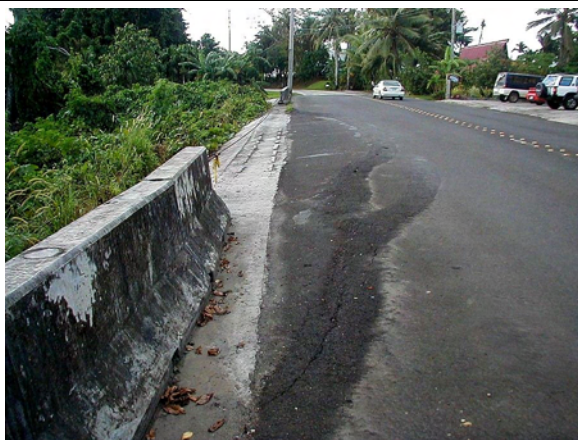
写真-9：トップサイドの舗装損傷箇所 コンクリートバリアーの回転および周囲の状況から、損傷原因は地滑りと思われる。
