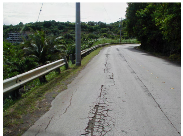
写真-10：豪州国海事公務官公邸付近の舗装損傷状況 ガードレールが傾いているが斜面全体は安定している。
