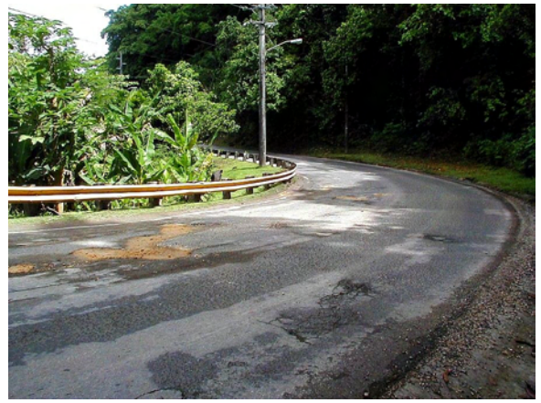
写真 8：区間 C の急なカーブが続く道路状況 ガードレールの位置が前過ぎる上に、樹木により視距が遮られている。
