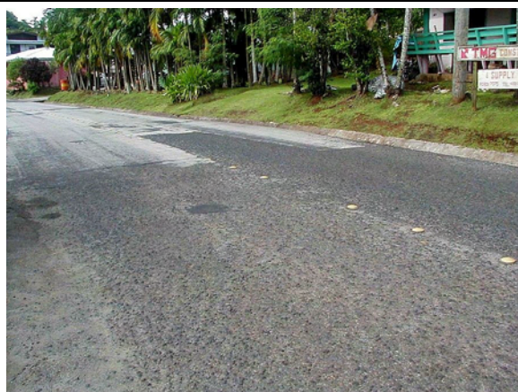
写真-6：舗装損傷状況例 3（区間 E1 のミュージンズスコウジョウ付近） 表層の骨材が抜け落ち（ラベリング）が進んでいる。
