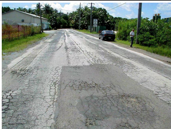
写真-5：舗装損傷状況例 2 舗装が劣化して亀甲状のひび割れが目立つ。簡便な補修方法では、ひび割れ発生を抑制できない。
