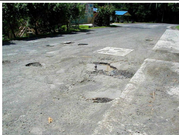
写真-4：舗装損傷状況例 1 多くのポットホールが点在し拡大している。舗装の損傷が急速に進行している。
