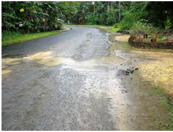
写真-7：排水不良箇所事例（パラオパシフィックリゾート付近） 右側に排水設備が無いことが原因。
