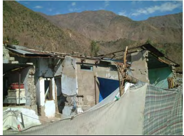
大きく損壊しているスタッフ住居
