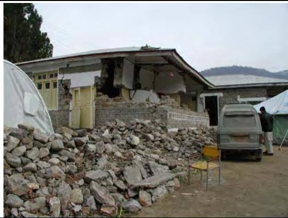
大きく損傷している外来診療棟
