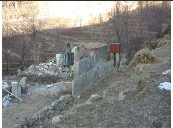
崩壊したスタッフ住居
