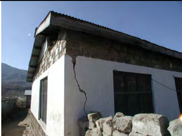
隅角部が大きく損傷している外来診療棟
