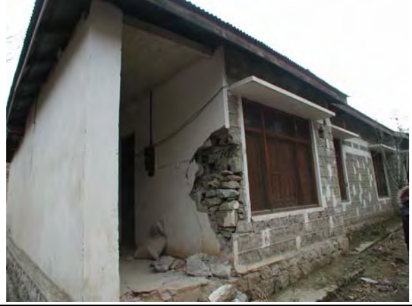
壁の一部が欠損したスタッフ住居
