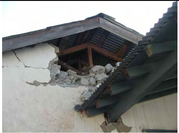
大きく損壊しているスタッフ住居
