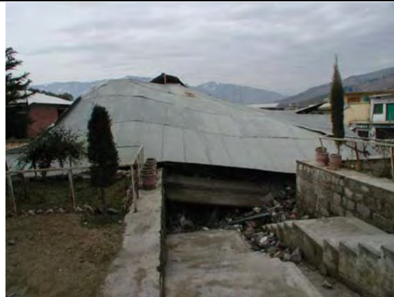
崩壊した外科診療棟
