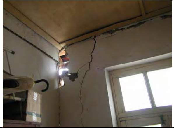
大きく損傷している外来診療棟
