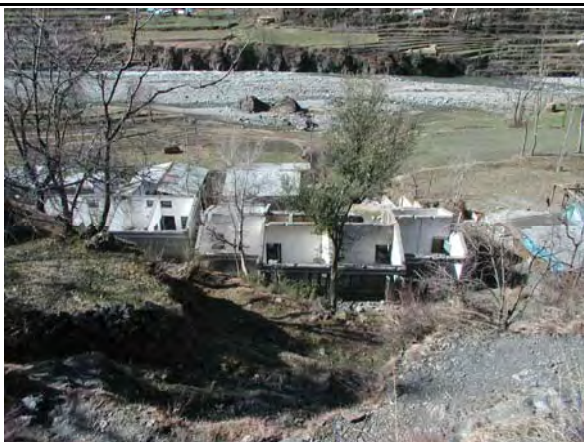
全ての屋根が崩落した施設全景
