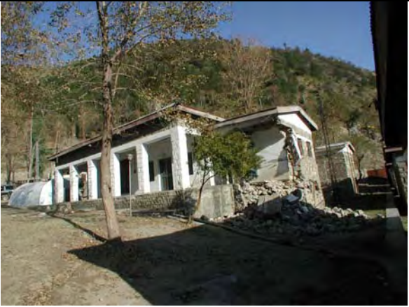
一部崩壊した外来診療棟
