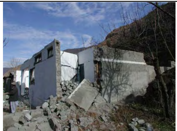
壁が崩落した外来診療棟
