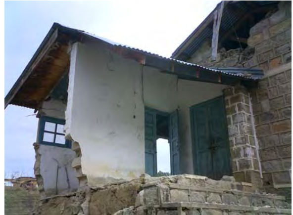
壁の一部が崩落しているスタッフ住居
