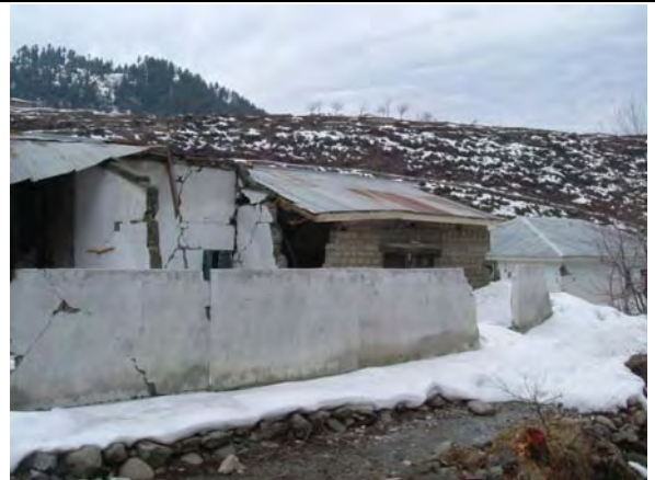
大きく損壊しているスタッフ住居
