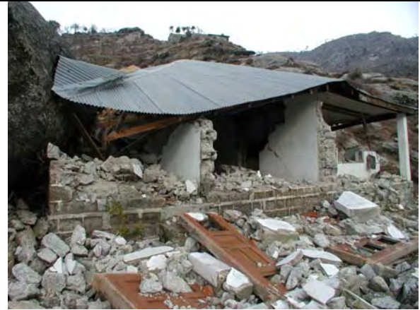
崩壊した外来診療棟
