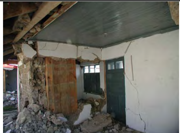
大きく損壊しているスタッフ住居
