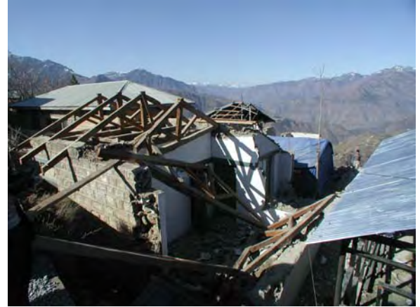
大きく損壊しているスタッフ住居
