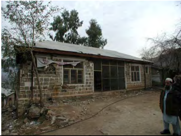
隅角部が崩落している外来診療棟
