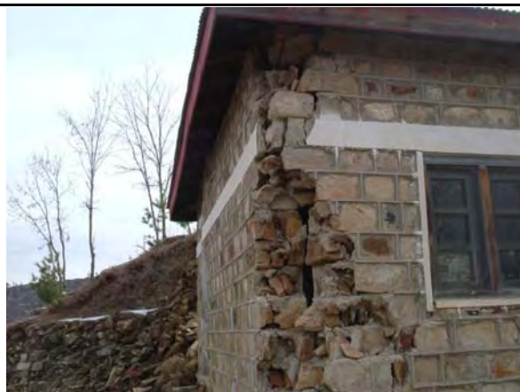
隅角部が崩壊している外来診療棟
