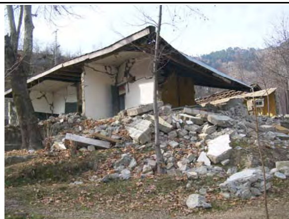
殆どの壁が崩落しているスタッフ住居
