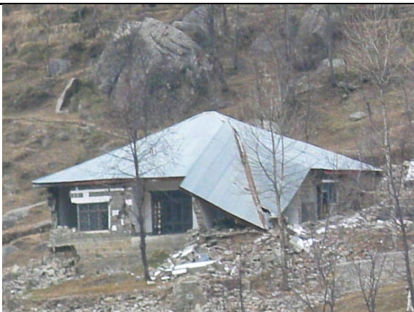
大きく損壊している外来診療棟
