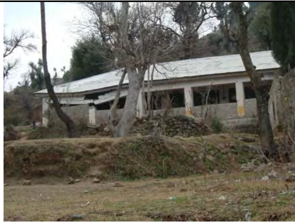
大きく損傷している外来診療棟
