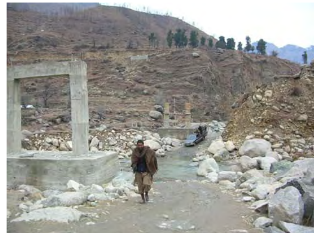
建設中の橋梁が被災し、建設工事は中止となった
