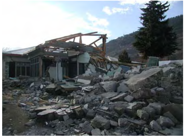
倒壊したスタッフ住居
