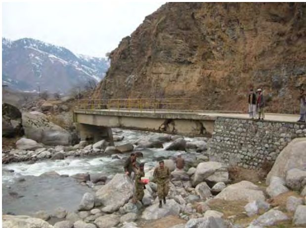
被災した橋梁
