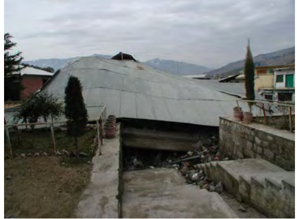
崩壊した外科診療棟
