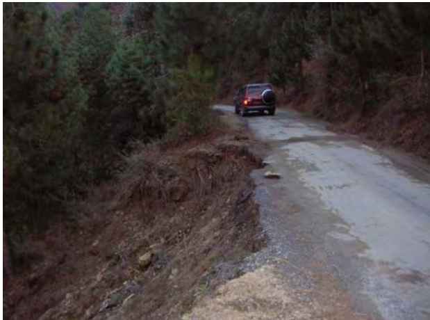
山側及び谷側の法面崩壊が見られる
