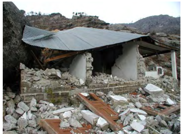
崩壊した外来診療棟
