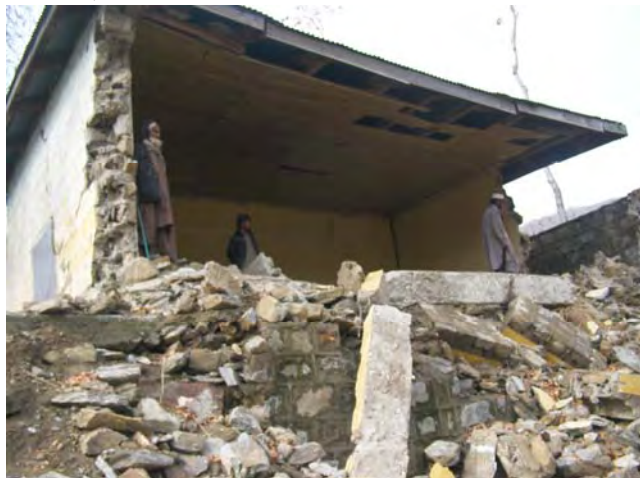
2 教室棟の道路側の壁が崩壊
