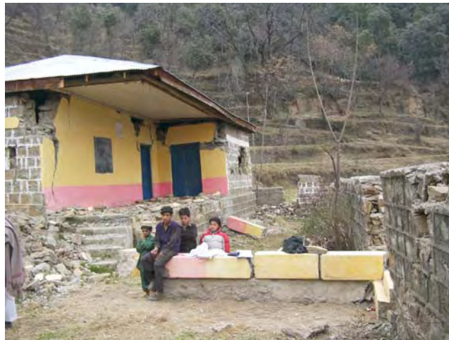
2 教室棟の柱及び梁が折れ曲った大規模な損傷
