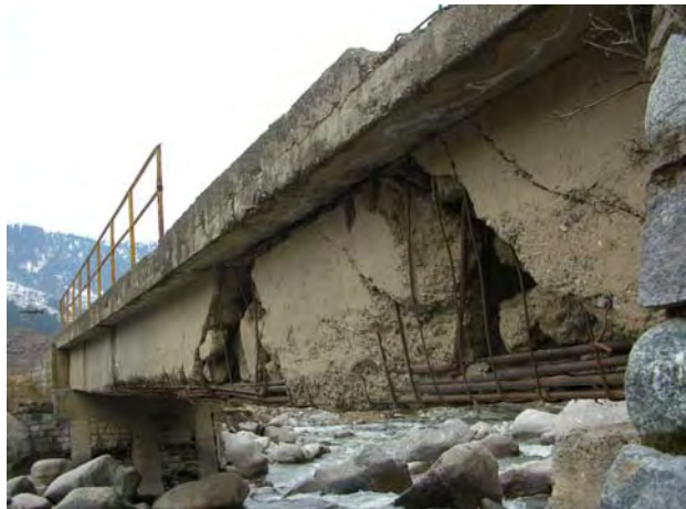
鉄筋の露出等の損傷が上部構造に見られる
