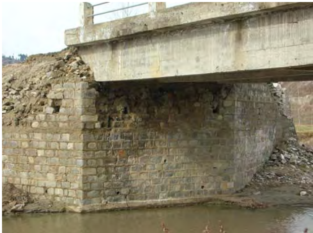
橋台部に地震による進行性の損傷が見られる
