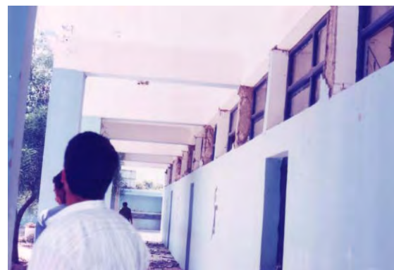
b) Rupture d'inflexion/cisaillement des poteaux
