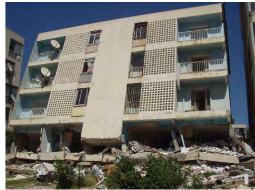
b) Destruction par effondrement de poteaux
