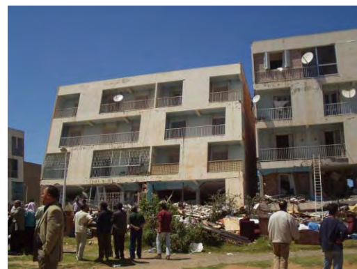
d) Destruction par effondrement de poteaux
