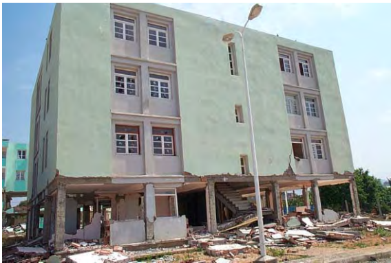
a) Dommages graves non structurels au 1er niveau
