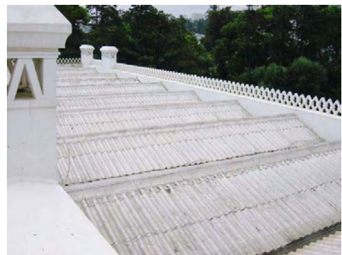
Photo 9-6 Nouveau palais: Toiture d'amiante de la salle principale
