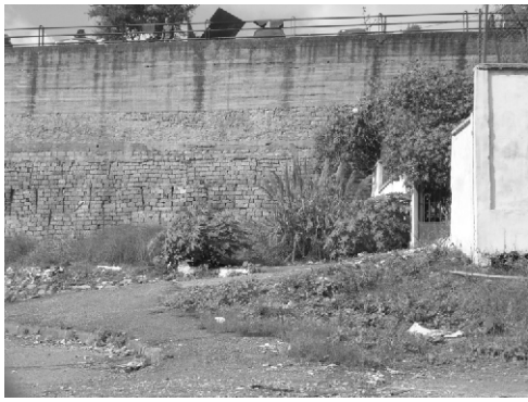
Photo 5-9 Mur détruit par glissement de terrain
