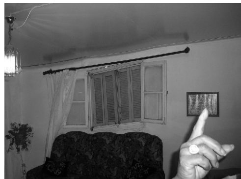
Photo 5-7 Fenêtre détruite par glissement
