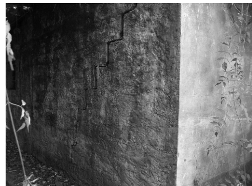
Photo 5-8 Mur détruit par glissement de terrain
